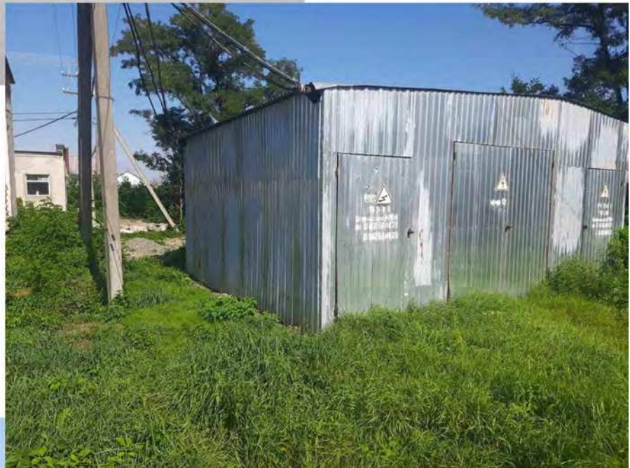
Фото 3. Діюча трансформаторна підстанція
